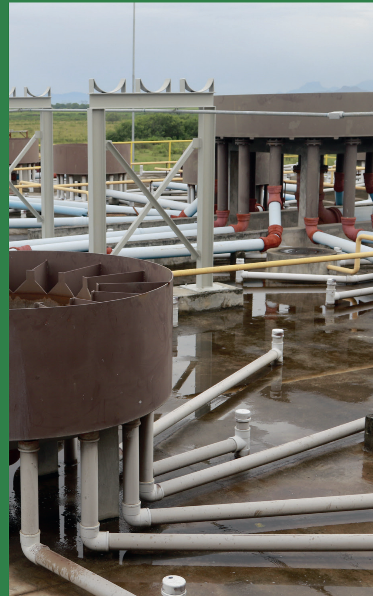
Obras do Coletor-Tronco de Santa Cruz, estação de tratamento de esgotos, por Marcelo Piu.
